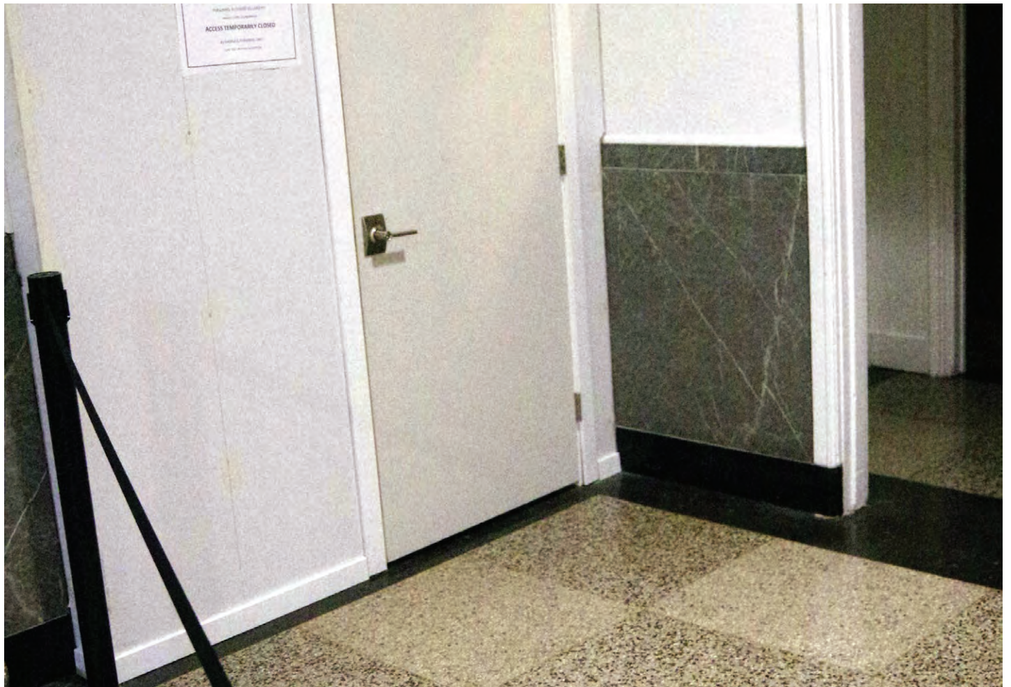
L'escalier pour aller de l'étage principal à l'hôtel de ville de VMR au niveau inférieur est fermé ces derniers temps afin que plus de 225 000 $ en restaurations puissent être effectués au sous-sol qui a été lourdement endommagé par l'inondation du 13 juillet.
